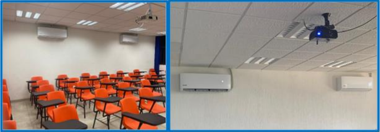
Ilustración 28 Aulas con aire acondicionado
